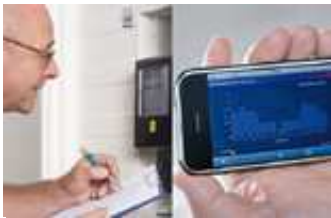
Smart-Metering für Strom- und Gas-Verbrauch.
